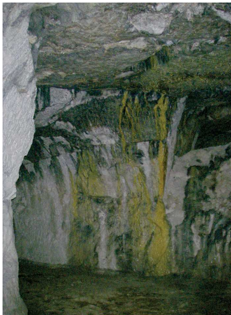
photo 3: Galerie sujette aux infiltrations en pied de versant (carrière Interparlementaire des Chênes)
